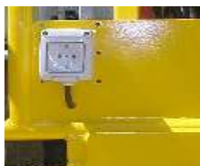
Foto 4 : Tomada eléctrica 220V
